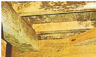
A 床下換気扇を設置していない床下
